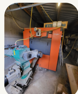
Chaudière biomasse installée chez Clément (©AWAF et Greenotec)
