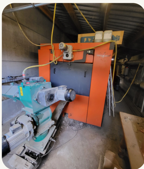
Chaudière biomasse installée chez un agriculteur (©AWAF et Greenotec)
